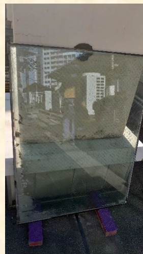
【ガラス天井面劣化状況】
